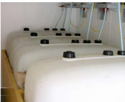
Zusatzmitteltanks Additive tanks
