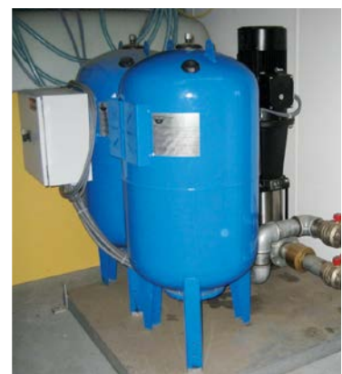
Druckerhöhungsanlage Water booster station
